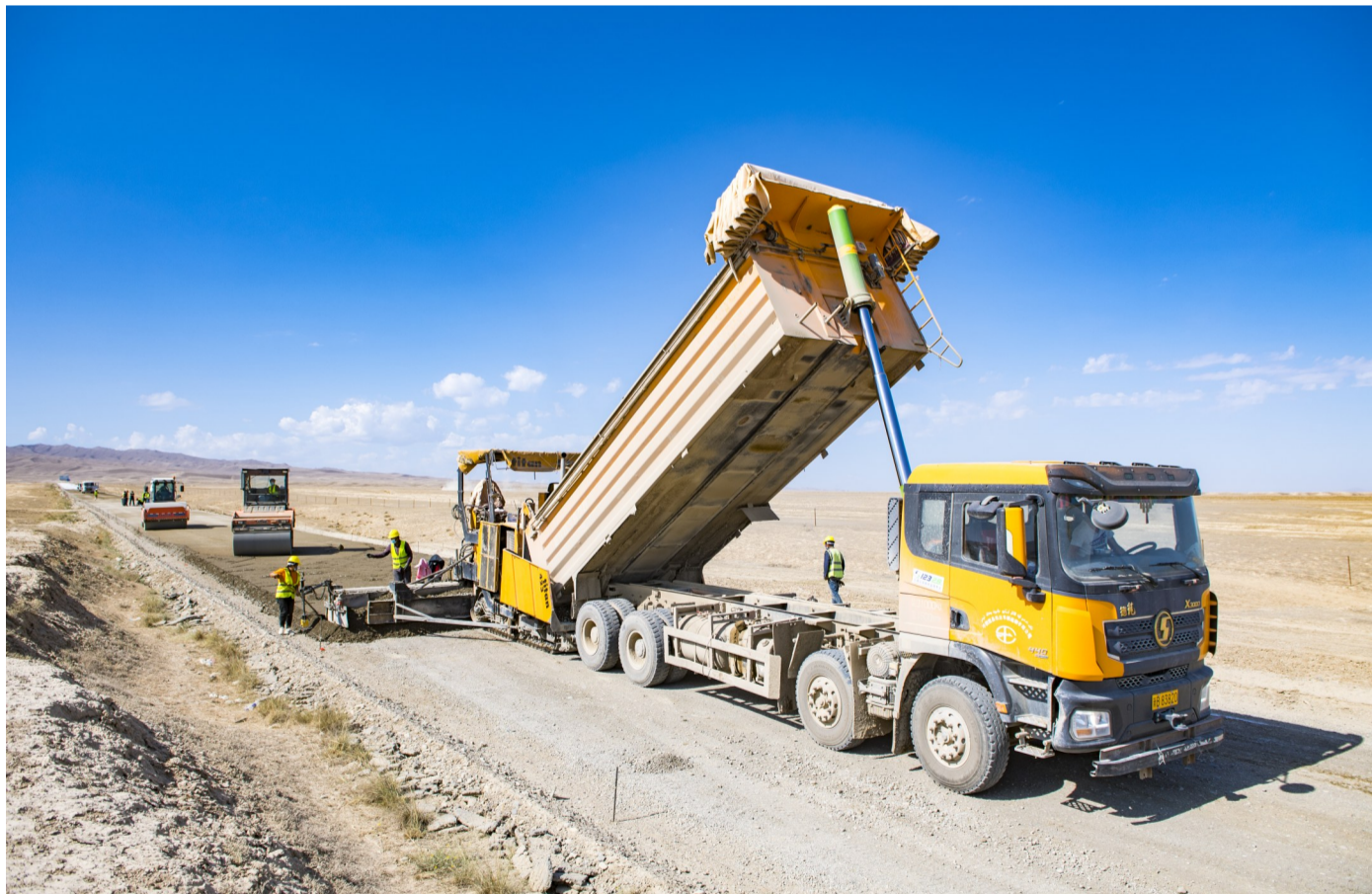
9月6日,呼图壁县X147线公路改建工程项目建设施工现场,工人们正在加紧施工。
