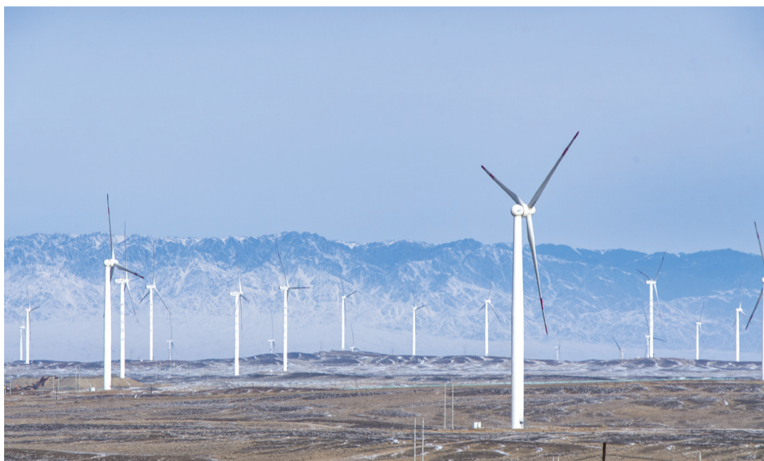
12月15日,正在运行当中的木垒县四十个井子风力发电项目。
