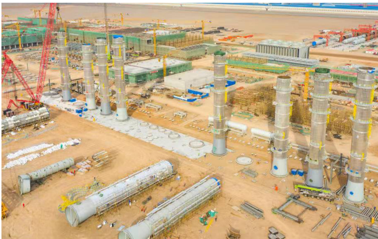
3月17日上午,准东经济技术开发区某企业年产20万吨高纯晶硅项目一期项目及配套设施项目正在加紧建设中。一期项目投产后可新增就业1200人。 本报记者 何龙 摄
