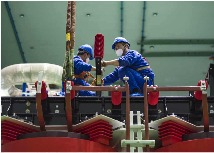
3月12日,特变电工新疆输变电科技产业园特高压生产车间,特变电工新疆变压器厂员工正在组装世界首台容量最大户外智能型50000千伏安/110千伏有载干式变压器。
