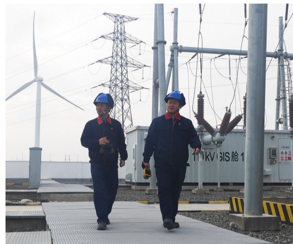
3月6日,在深圳能源新疆分公司老君庙风电一场,运维工程师俞东和同事正在查看电气设备。
