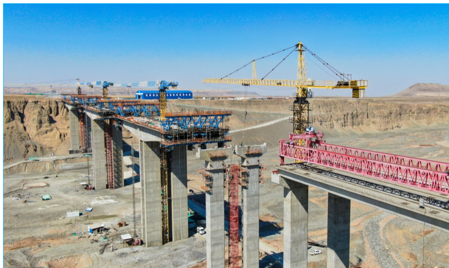
3月25日,大型机械在昌吉州西部南山伴行公路项目(一期)呼图壁河大桥施工现场施工。该项目(一期)线路全长69公里,全线采用一级公路设计标准,总投资19.98亿元,是昌吉州重点公路建设项目。 本报记者 陶维明 摄
