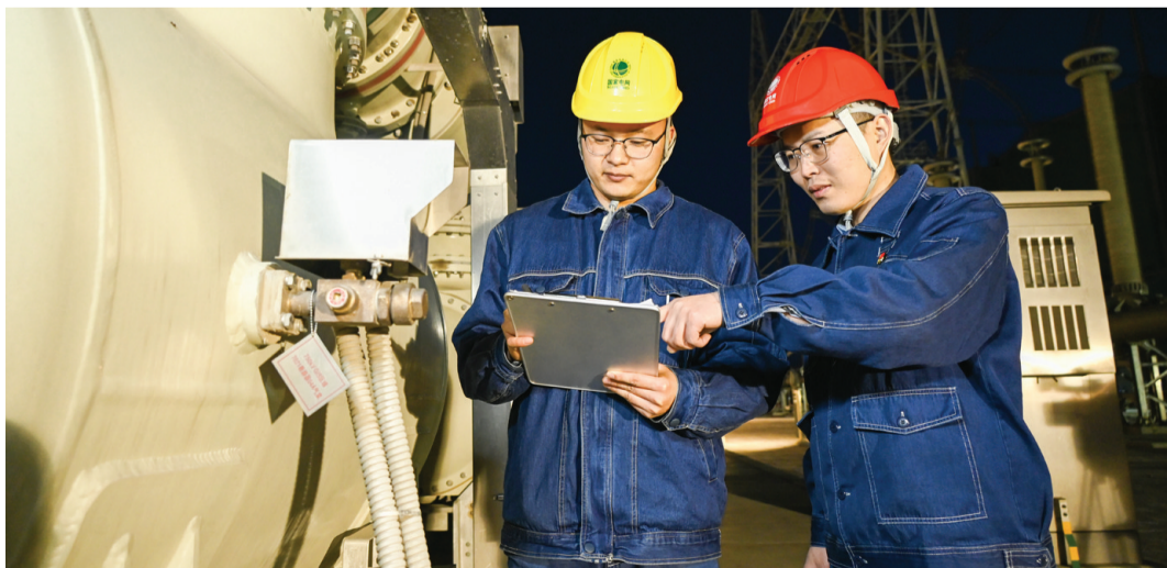
3月23日,在位于新疆准东经济技术开发区的国网新疆超高压分公司±1100千伏昌吉换流站,直流运检技术专责王权(右)正在和同事对设备进行巡检登记。
