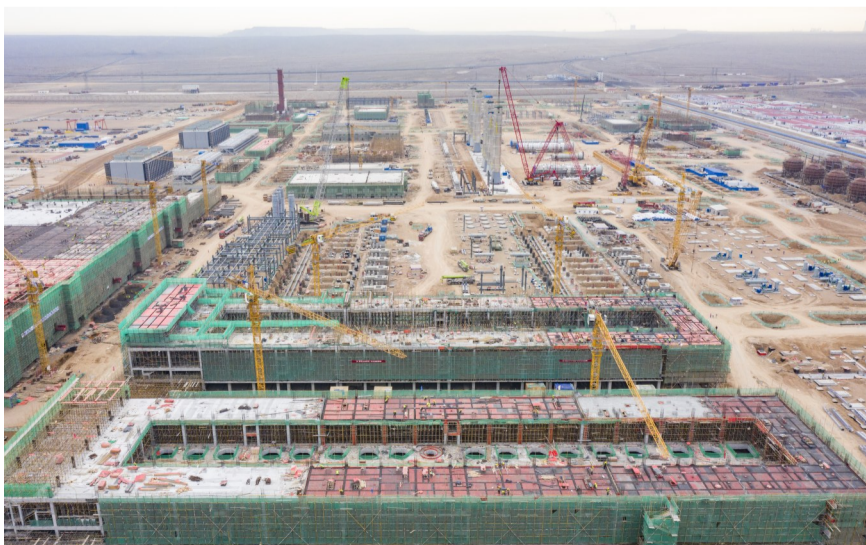
准东经济技术开发区新疆其亚硅业有限公司年产一期项目及配套设施项目加紧建设中。 本报记者 何龙 摄
