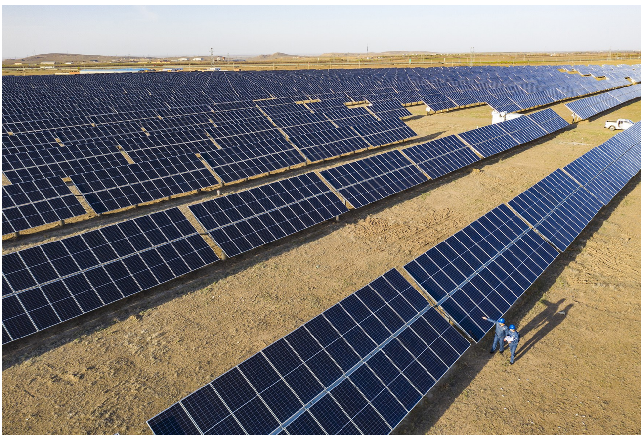
5月21日,位于吉木萨尔县老台乡的光伏产业园,华能新疆吉木萨尔新能源有限公司光伏发电站工作人员正在对设备进行巡检。近年来,吉木萨尔县积极践行生态优先、绿色发展理念,持续推进产业和能源结构调整,通过利用荒山戈壁,大力发展光伏发电产业,目前已建成59万千瓦光伏产业园。 本报记者 何龙 摄
