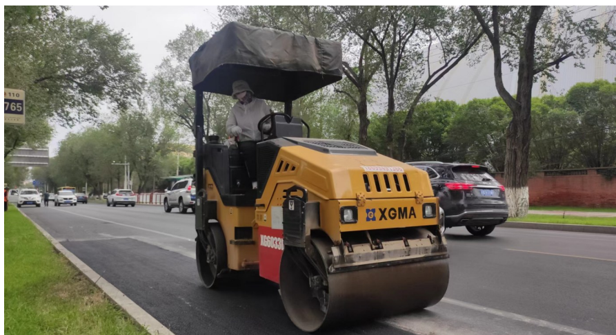
8月3日,昌吉市市政养护工人正在昌吉市红星路上修补路面。 贾兴旺 摄
