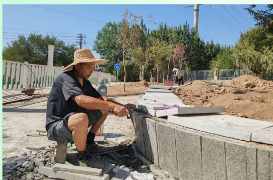
8月11日,昌吉市“绿屿间”生态花卉科普园项目建设现场,工人正在施工。 本报记者 马晓芳 摄
