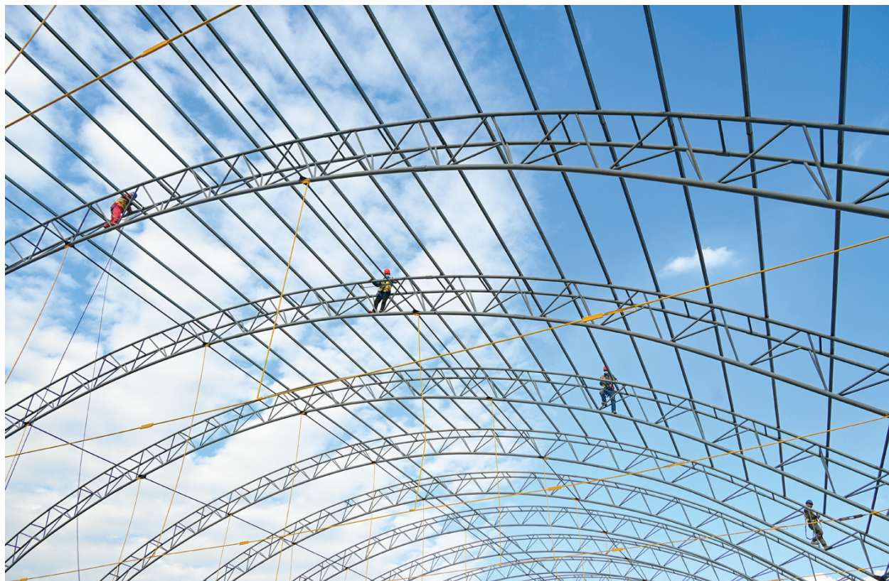
9月16日,在位于呼图壁县工业园新材料产业园区的新疆格莱美特活性炭有限公司工程技术提升项目炭化料棚施工现场,工人正在加紧施工。
