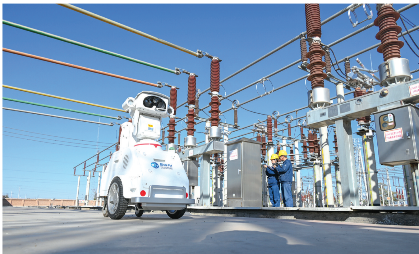
9月27日,在昌吉市220千伏长宁变电站,智能巡检机器人正在对供电设备进行巡检。随着中秋节和国庆节的临近,国网昌吉供电公司采取人工巡检与智能机器人巡检相结合的方式,加大巡检力度、增加巡检频次,确保节日期间供电设备运行正常。
