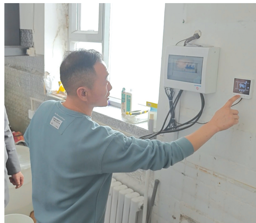
北五岔镇沙窝道村村民杨仕江家进行了清洁取暖“煤改电”改造，新安装了电采暖设施。 □张海洋摄
